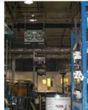
车间焊接烟尘整体净化
