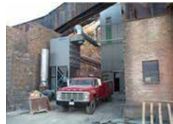
耐火材料烟尘除尘系统
