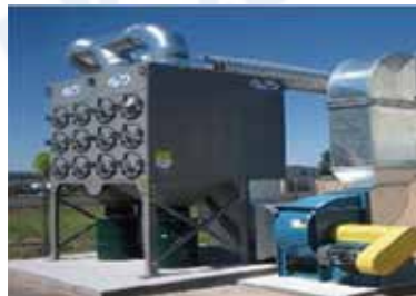
焊接烟尘净化系统， 净化后的洁净空气返回车间
