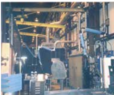
集中式焊接烟尘除尘系统
